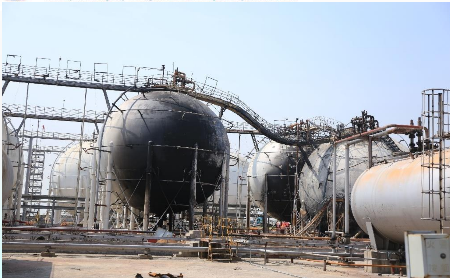
事故受损的储罐区
